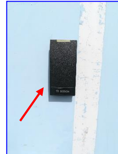
Sensor / lector de tarjeta para control de acceso a sala de control.
