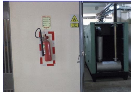
Extintor portátil de CO2 en Subsuelo 1
