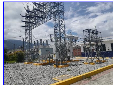
Pórtico de Alta tensión
