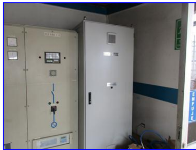
Equipos de comunicación SCADA
