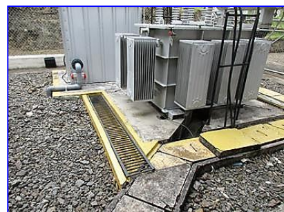
Cubeto de contención de derrames
