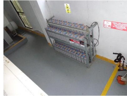
Banco de baterías
