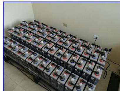
Banco de baterías
