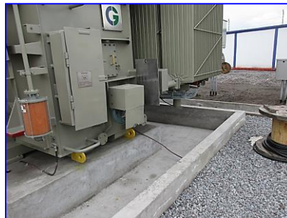
Cubeto de contención de derrames (transformador por instalarse)
