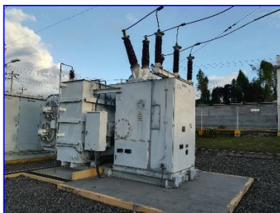
Transformador de Potencia 10 MVA, ABB
