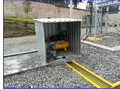
Sistema de Bombeo en caso de derrames.
