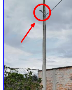
Cámaras de seguridad para exteriores.
