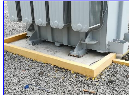
Los transformadores cuentan con cubetos, para el caso de derrames.
