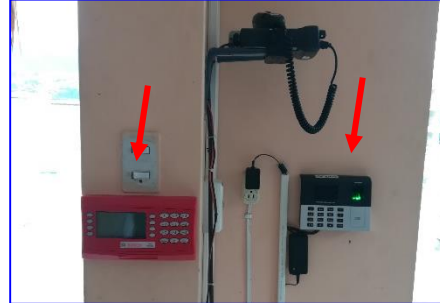
Equipo biométrico y sistema de alarma.
