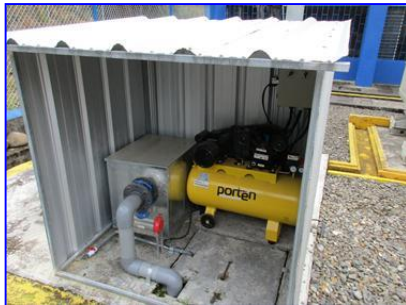
Sistema de bombeo en caso de derrame
