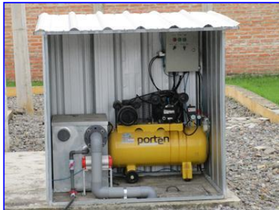
Sistema de bombeo en caso de derrame
