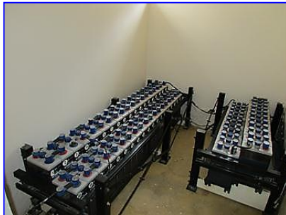
Bancos de baterías
