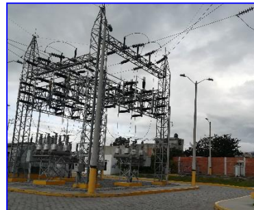
Portico de alta tensión
