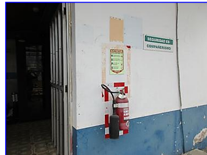
Extintor de incendios portátil
