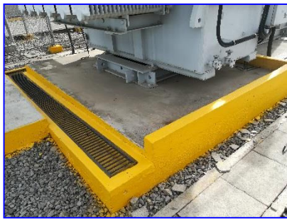
El Transformador de Potencia cuenta con un cubeto de retención
