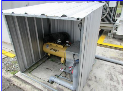
Sistema de bombeo en caso de derrame
