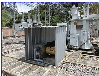
Sistema de bombeo en caso de derrame
