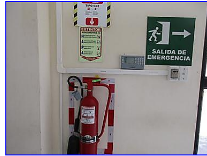
Extintor de incendios portátil
