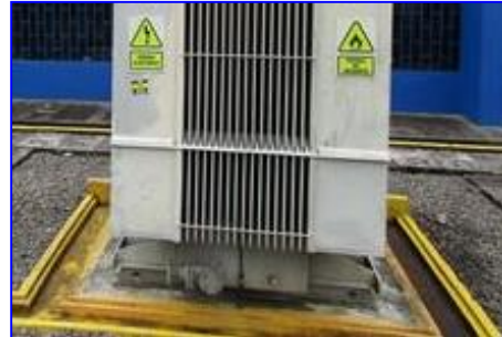
Cubeto de contención de derrames
