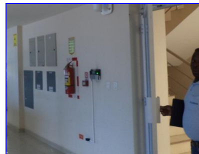
Extintor portátil de CO2 en oficinas.
