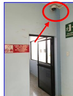
Cámaras tipo domo al interior de la sala de control.
