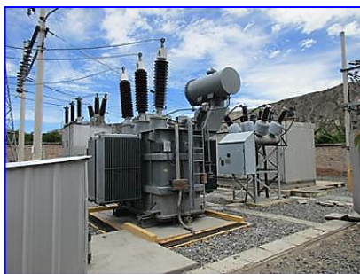
Transformador de Potencia 6,25 MVA
