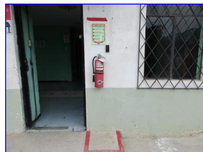
Extintor de incendios portátil
