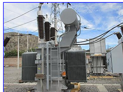
Transformador de Potencia 5 MVA
