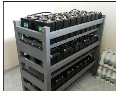
Banco de baterías
