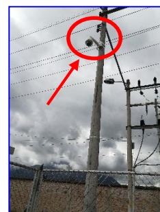
Cámaras tipo domo al exterior de la Subestación
