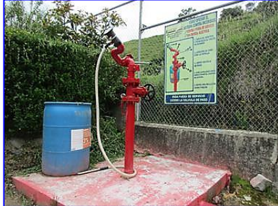
Sistema contra incendios por Chorro de Espuma
