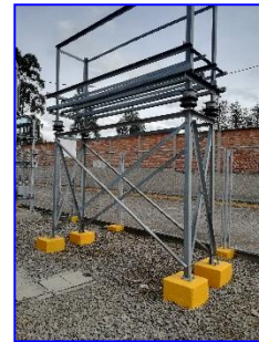
Portico de seccionadores
