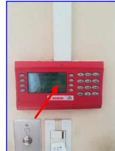
Botón de apertura de puerta y alarma de acceso.
