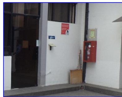
Extintor portátil de CO2, patios.
