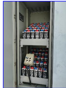
Banco de baterías al interior del Tablero de Control
