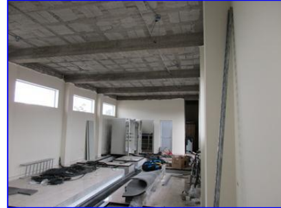
Nuevo cuarto de control de equipos
