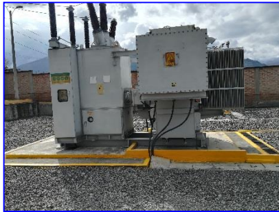
Transformador de Potencia 20 MVA, ABB
