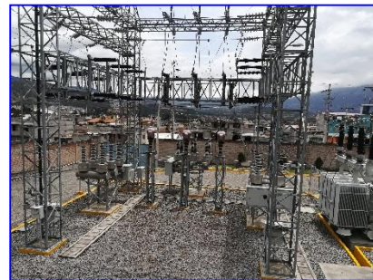
Portico de seccionadores
