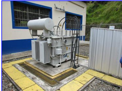
Transformador de Potencia
