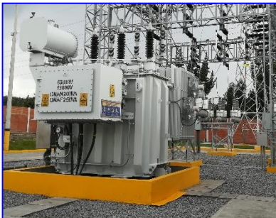
Transformador de Potencia 20 MVA, ABB
