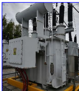
Transformador Shaanxi Hanzhong
