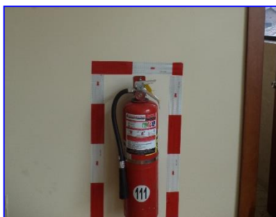
Extintor portátil de CO2, oficinas
