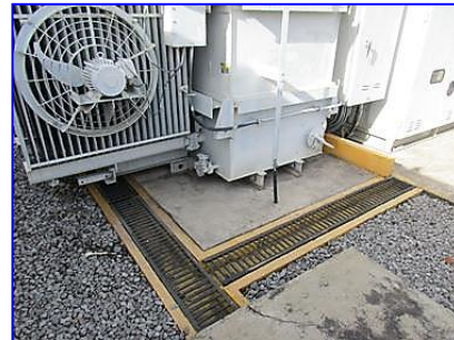
Cubeto de contención de derrames
