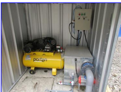
Sistema de bombeo en caso de derrame
