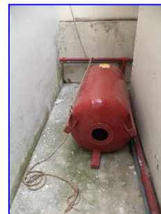
Tanque el SCI en mal estado
