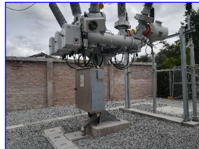
Disyuntores del patio de maniobras
