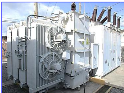
Transformador de Potencia 10 / 12,5 MVA
