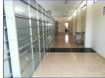
Interior de la Sala de Control.
