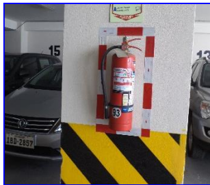
Extintor de CO2 en Subsuelo 2
