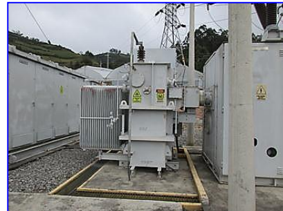
Cubeto de contención de derrames
