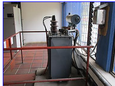
Transformador para Servicios Generales
