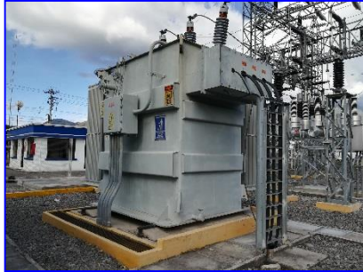
Transformador de Potencia 10 MVA, ABB
