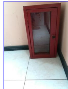
Al interior de la casa del operador existe un gabinete sin el extintor.
