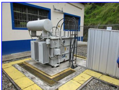
Transformador de Potencia
