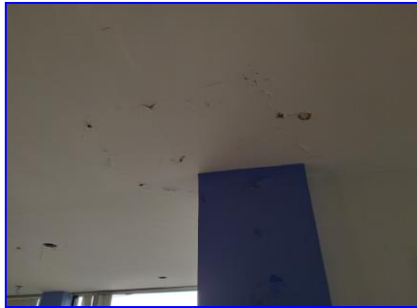
Recubrimiento de paredes desprendido
