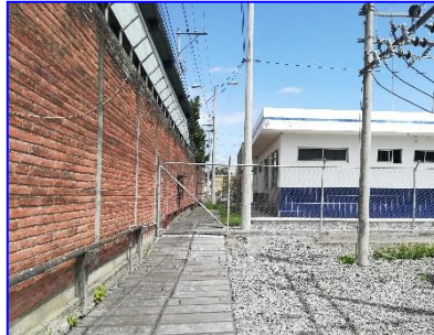
Cerco Eléctrico sobre el muro perimetral
