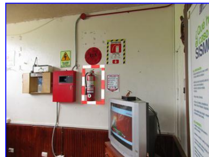
Extintor de incendios portátil
