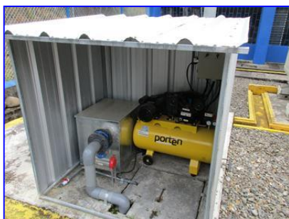
Sistema de bombeo en caso de derrame
