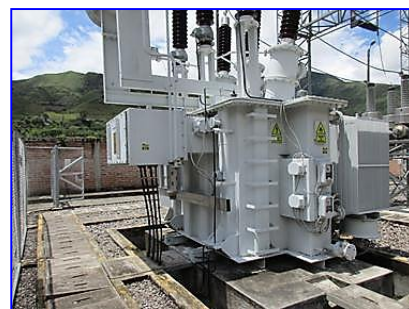
Cubeto de contención de derrames
