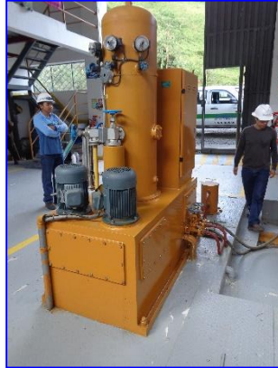
Estación de lubricación
