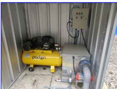
Sistema de bombeo en caso de derrame
