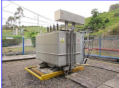
Transformador de Potencia
