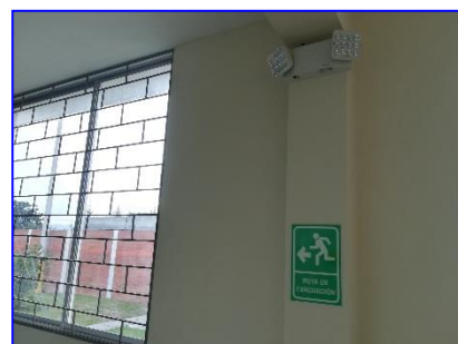
Rejas metálicas externas y luces estroboscópicas
