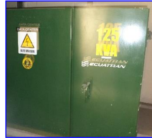
Transformador Data Center
