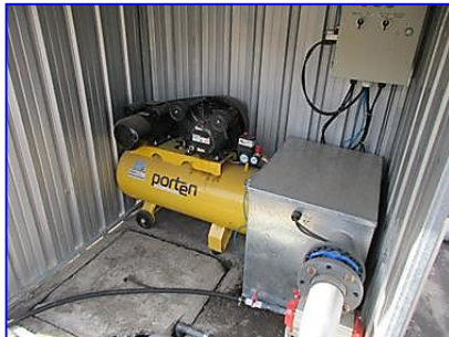
Sistema de bombeo en caso de derrame
