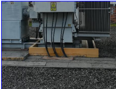
El Transformador con un cubeto de retención
