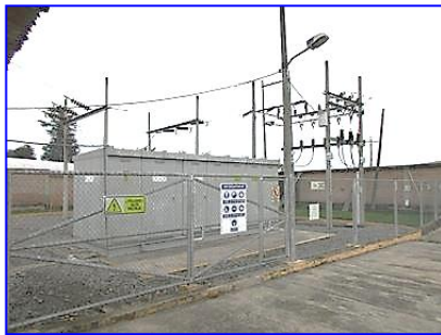
Equipos de la subestación
