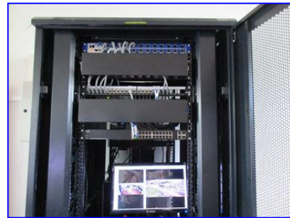
Equipos de comunicación SCADA
