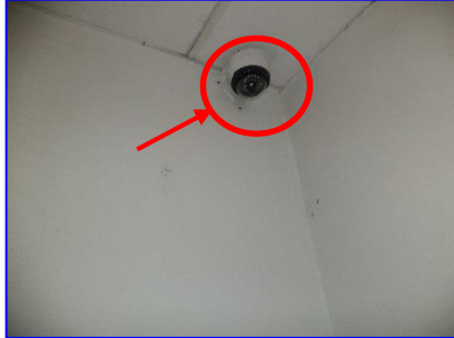
Cámaras tipo domo para vigilancia interiores.
