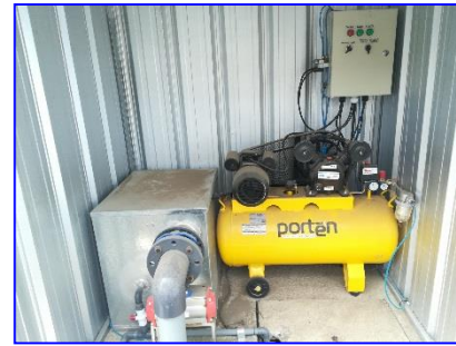
Sistema de Bombeo en caso de derrames.
