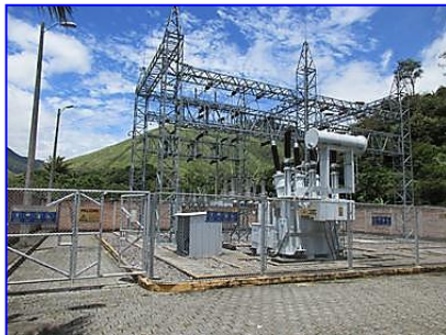
Equipos de la subestación
