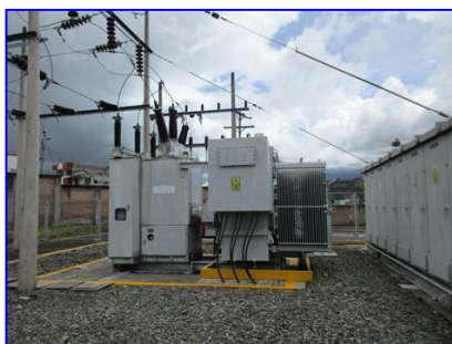
Transformador de Potencia
