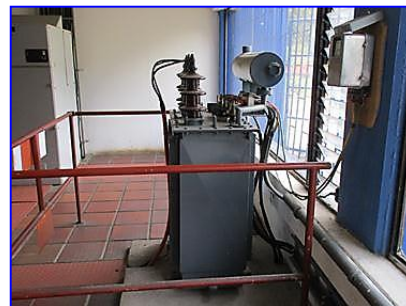
Transformador para Servicios Generales
