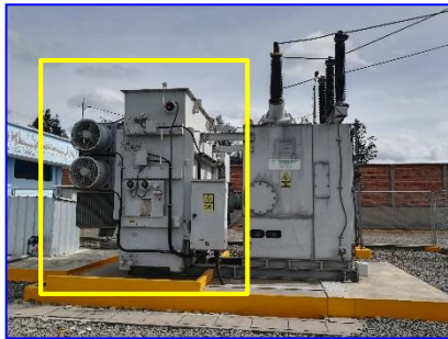
Transformador Mitsubishi de 10 MVA,
