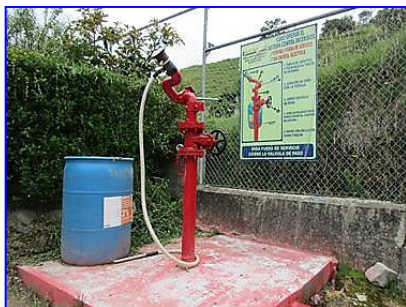
Sistema contra incendios por Chorro de Espuma
