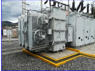
El Transformador de Potencia cuenta con un cubeto de retención
