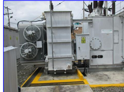
Cubeto de contención de derrames
