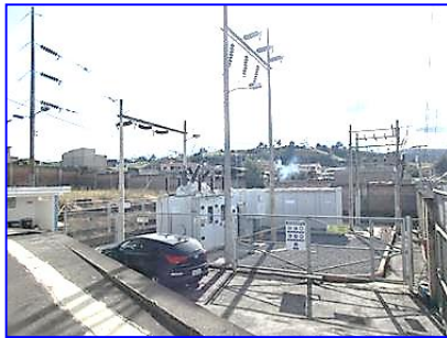
Equipos de la subestación
