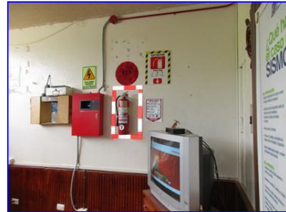
Extintor de incendios portátil
