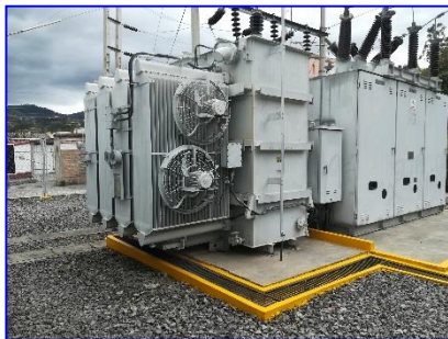
Transformador Mitsubishi de 10 MVA,
