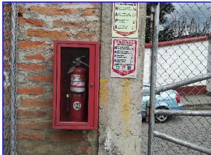
Extintores de CO2
