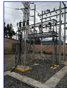
Portico de seccionadores
