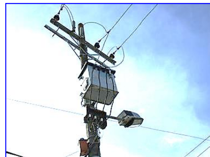
Transformador Servicios generales 30 kVA
