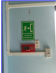
Controlador de Alarma y botón de apertura de puerta en la sala de control
