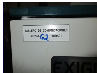
Equipos de comunicación SCADA
