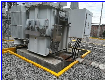
Transformador de Potencia 10 MVA, ABB
