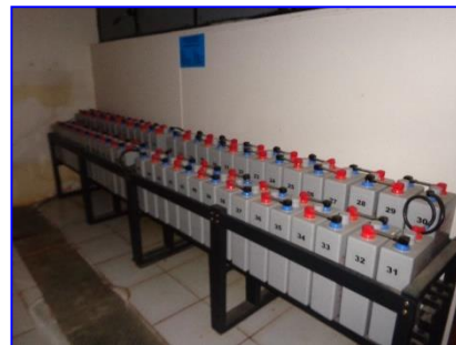
Banco de baterías
