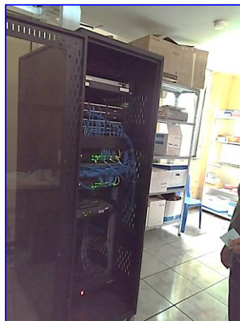
Rack de Equipos
