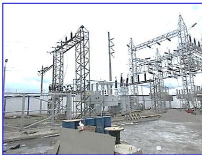
Equipos de la subestación
