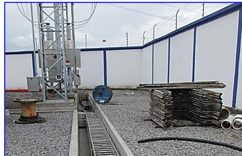
Cerramiento perimetral y cerco eléctrico
