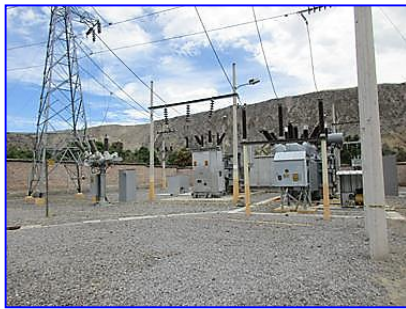
Equipos de la subestación
