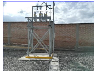
Portico de seccionadores
