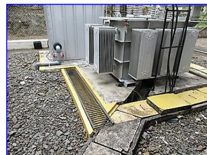
Cubeto de contención de derrames
