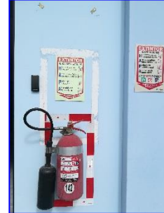
Extintores de CO2 y Polvo Químico Seco.
