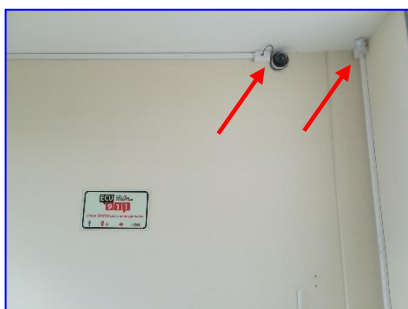
Cámaras sensores de movimiento.
