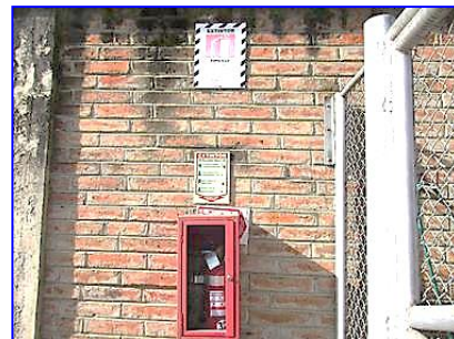
Extintor de incendios portátil
