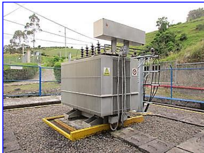
Transformador de Potencia
