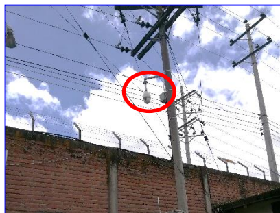
Cámaras de vigilancia.
