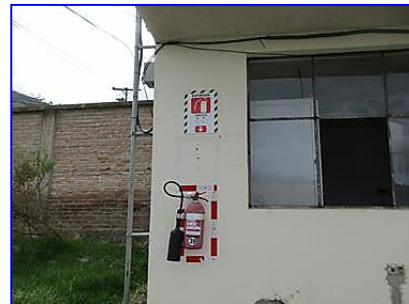
Extintor de incendios portátil
