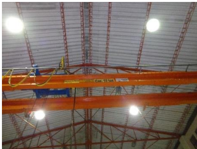
Puente grúa de 10 ton de capacidad
