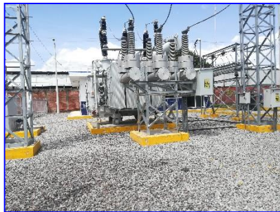
Transformador y Disyuntor
