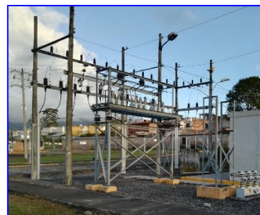
Portico de alta tensión
