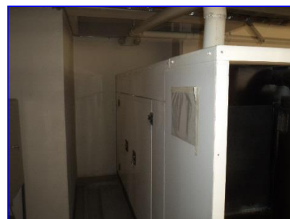
Generador Data Center
