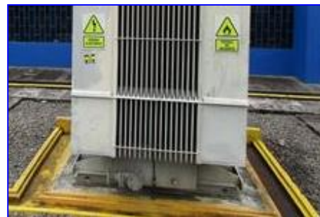
Cubeto de contención de derrames
