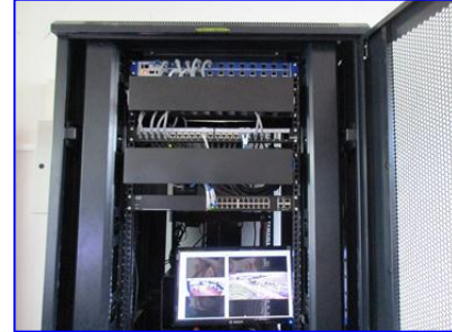
Equipos de comunicación SCADA
