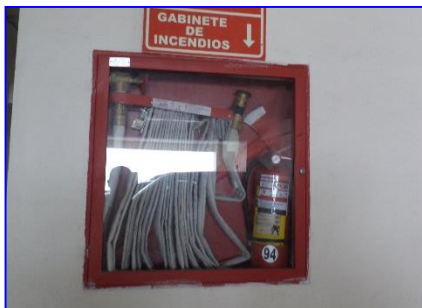
Gabinete Contra incendio
